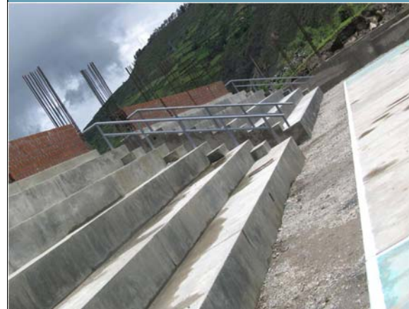
La obra cuenta con tribuna con graderías, servicios higiénicos, cerco perimétrico, estacionamiento, entre otros.
