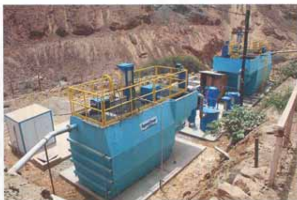
Planta de tratamiento de aguas servidas
